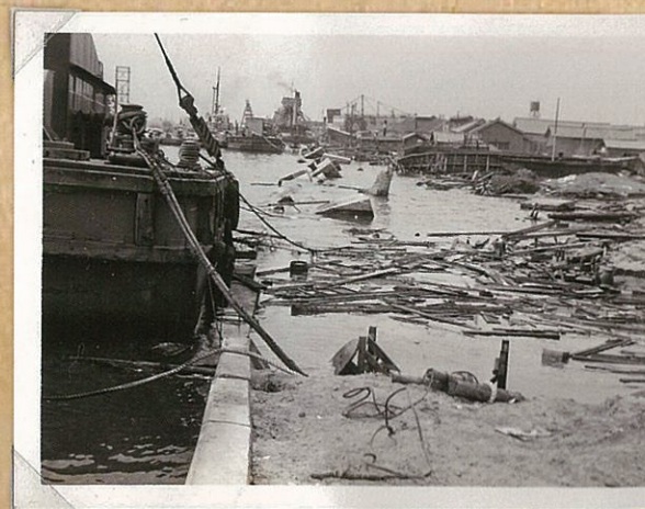
新潟港工事事務所構内の護岸決壊。
